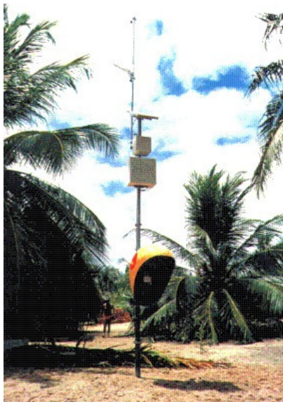
Figura 7.5 - Sistema de cabine telefônica financiado pela TELASA - TELECOMUNICAÇÕES DE ALAGOAS S.A.
